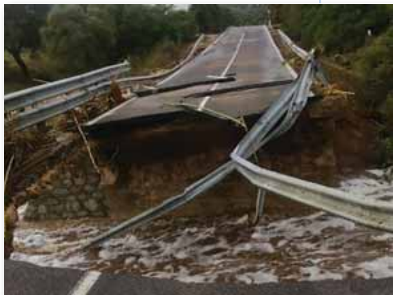
Effetti dell'alluvione in Sardegna
